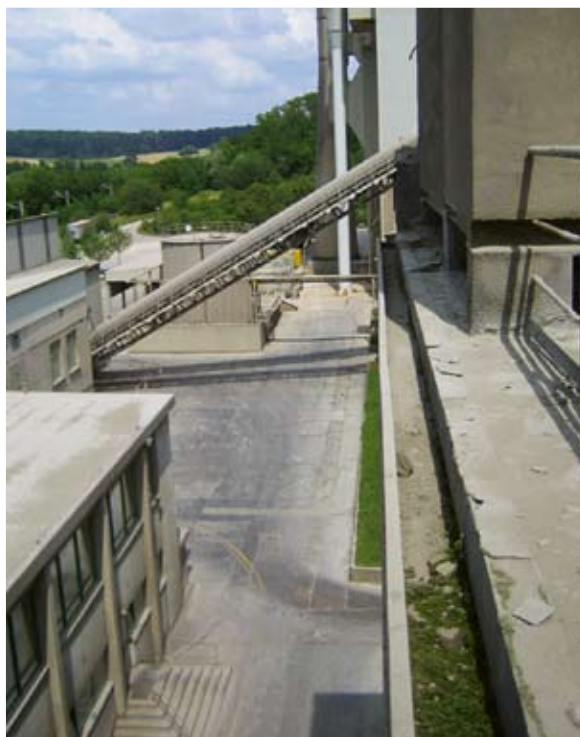
1 The plant before commencement of the construction phase Werksansicht vor Beginn der Bauphase
